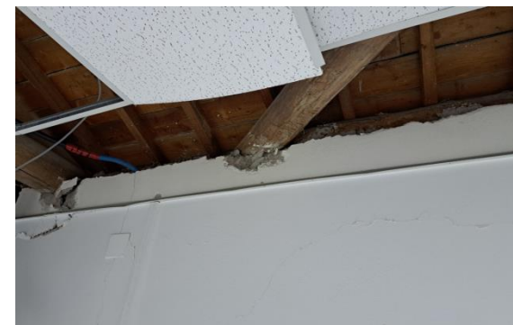
Κακή σύνδεση τοιχοποιίας με στέγη
